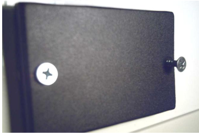
Fig. 3 Vista de la tapa interior una vez retirada la tapa exterior
